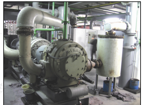
Старый насос Wittig заменен на UV50 в 2004 г
