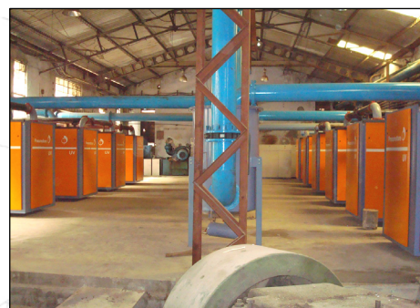
Pumpenraum mit 10 x UV50 VS90 HC
